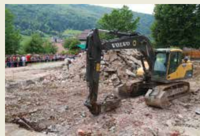
Starega so že porušili.
